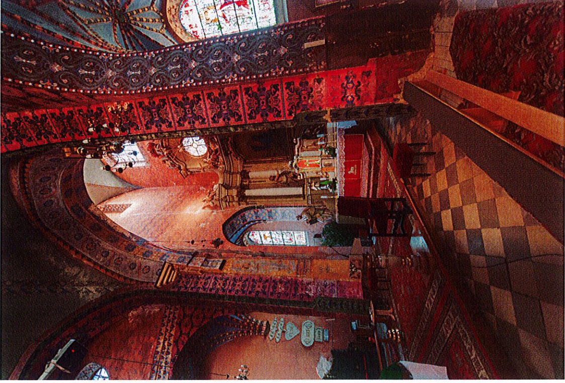
Fot. 1 Wnętrze kościoła p.w. Najświętszej Maryi Panny Wniebowziętej, św. Jana Chrzyciela i św. Jana Ewangelisty w Lwówku. Widok ogólny w kierunku prezbiterium kościoła. Widoczna degradacja malowideł na powierzchni ścian, sklepień i filarów.
