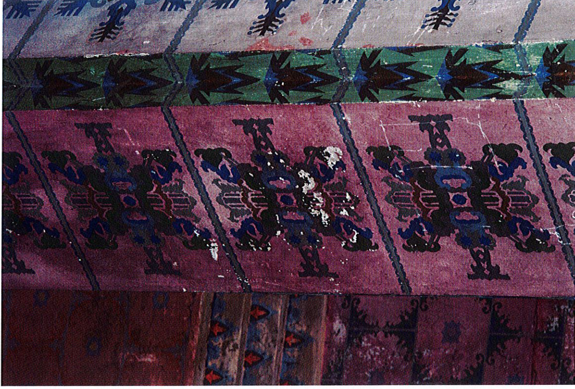
Fot. 16 Wnętrze kościoła p.w. Najświętszej Maryi Panny Wniebowziętej, św. Jana Chrzyciela i św. Jana Ewangelisty w Lwówku. Fragment filara nawy głównej. Widoczna degradacja malowideł na powierzchni filara i ściany.
