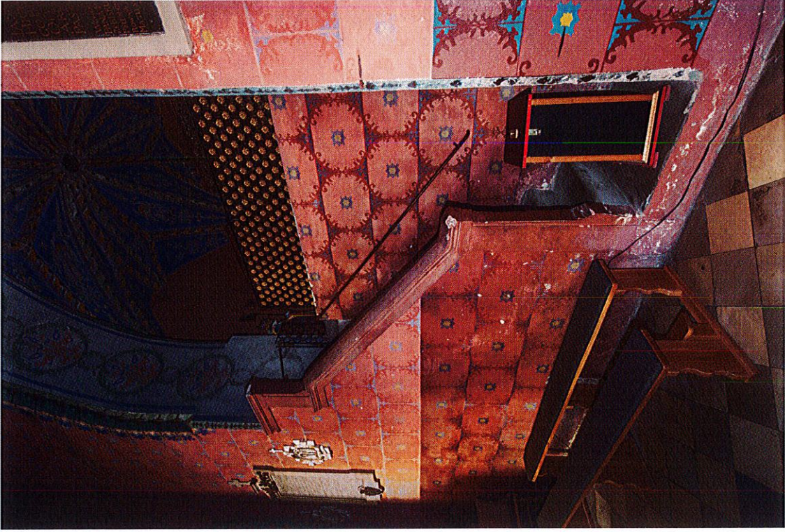
Fot. 11 Wnętrze kościoła p.w. Najświętszej Maryi Panny Wniebowziętej, św. Jana Chrzyciela i św. Jana Ewangelisty w Lwówku. Widok w kierunku nawy północnej i kaplicy na piętrze. Widoczna degradacja malowideł na powierzchni ścian i sklepień.
