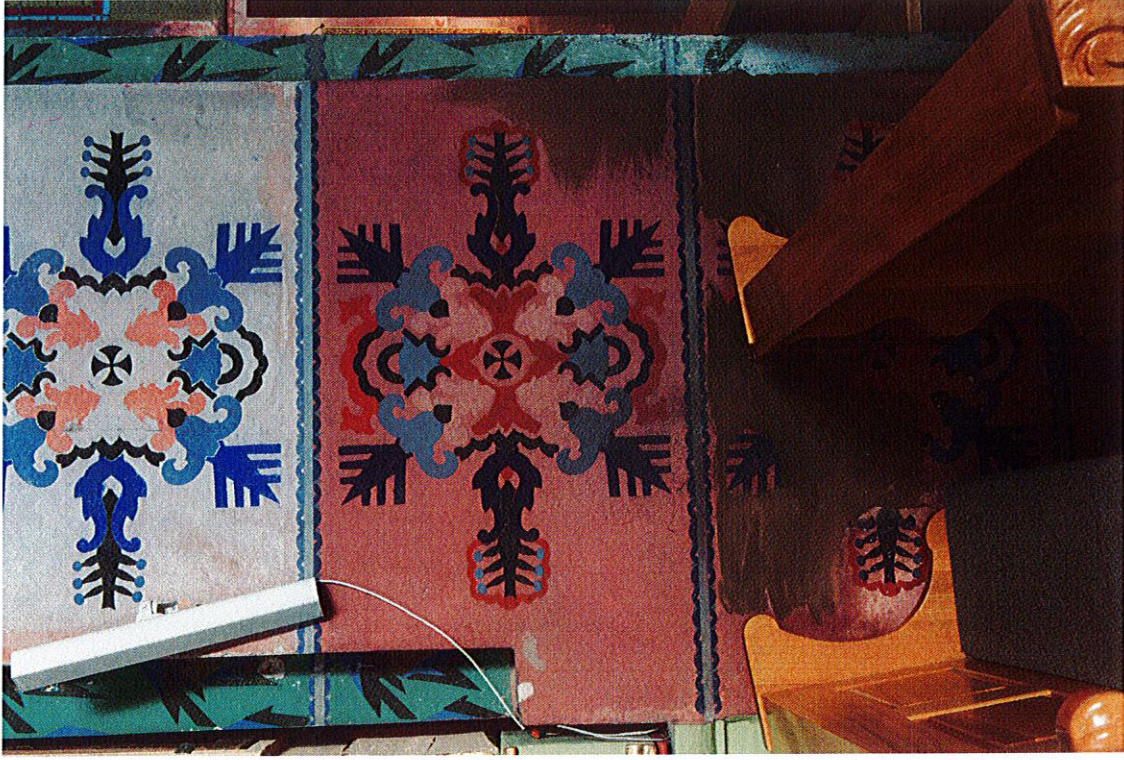
Fot. 22 Wnętrze kościoła p.w. Najświętszej Maryi Panny Wniebowziętej, św. Jana Chrzyciela i św. Jana Ewangelisty w Lwówku. Fragment nawy głównej. Widoczna degradacja tynków i malowideł.
