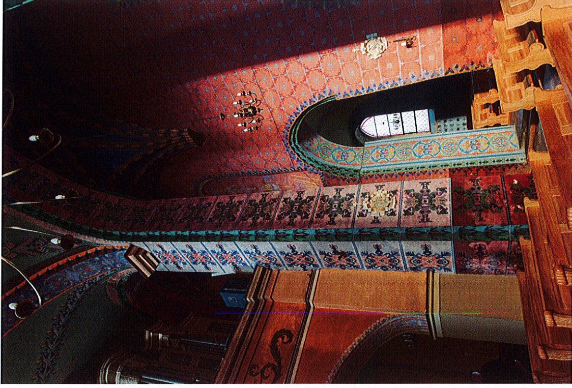
Fot. 6 Wnętrze kościoła p.w. Najświętszej Maryi Panny Wniebowziętej, św. Jana Chrzciciela i św. Jana Ewangelisty w Lwówku. Widok ogólny z nawy głównej w kierunku nawy północnej. Widoczna degradacja malowideł na powierzchni ścian i filarów.
